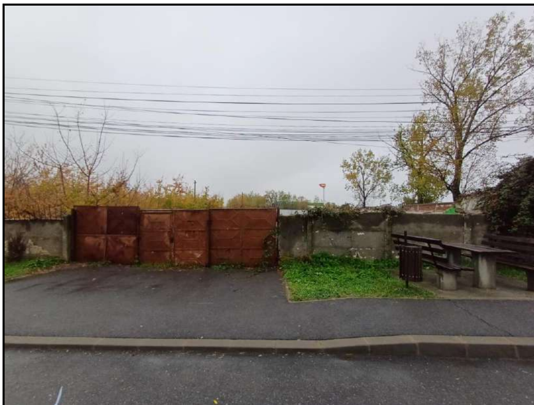
Amplasamentul studiat- NC 88327 – construcții existente în stare de degradare, propuse pentru desființare
